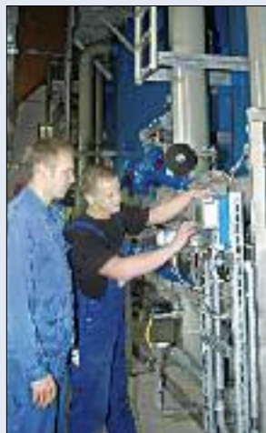
■ Maschinist Stephan Welzel (l.) prüft mit Lehrling Dennis Kuhnke die Filteranlage im Wasserwerk Königs Wusterhausen.
