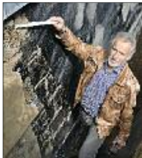
■ Dieter Kleinert findet die Ursachen für Schäden an Gebäuden.
